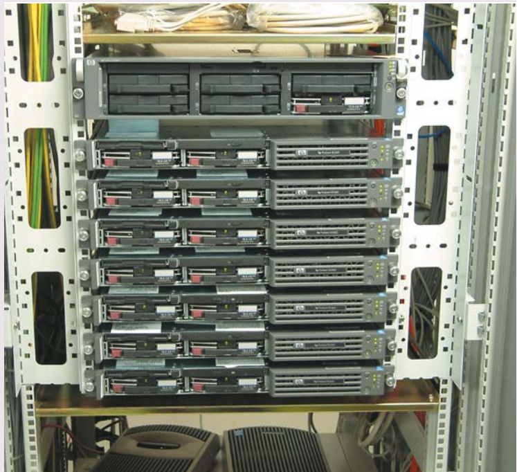
Granja de servidores instalada en la Dirección General de la Marina Mercante.
